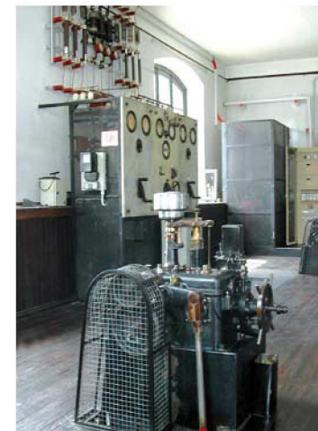
Vedute del quadro di comando
